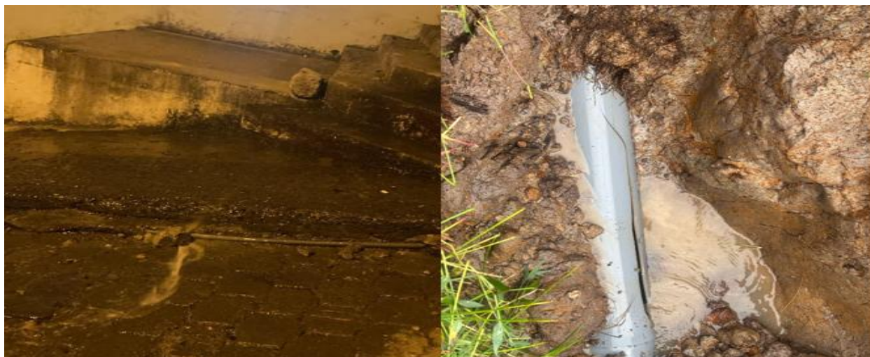
Figura 17. Colapso de tubería por el exceso de presión.
