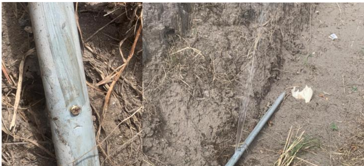
Figura 13. Perforaciones en las tuberías de distribución.
