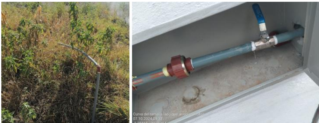
Figura 24. Conexiones autorizadas sin micromedición
