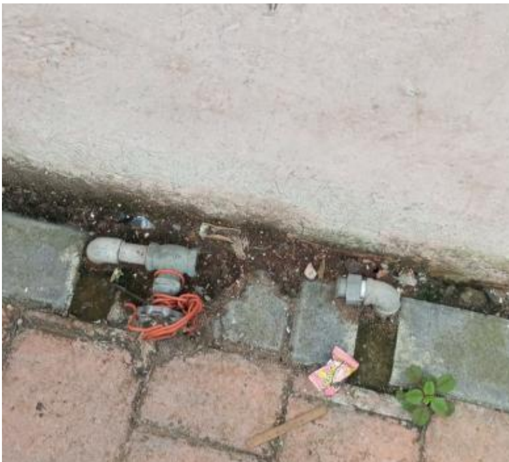
Figura 14. Malas conexiones domiciliarias.
