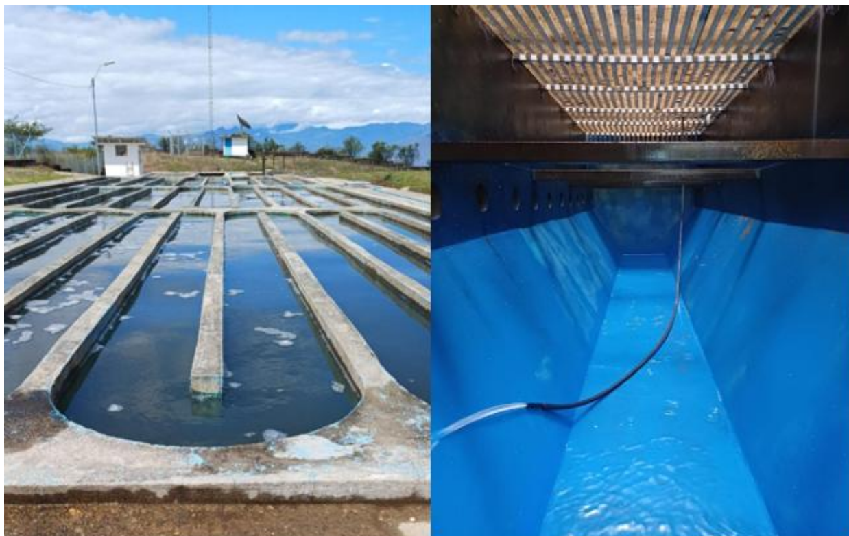
Figura 3. Modulo floculador y sedimentador de la planta de tratamiento de tratamiento de Pilancón.
