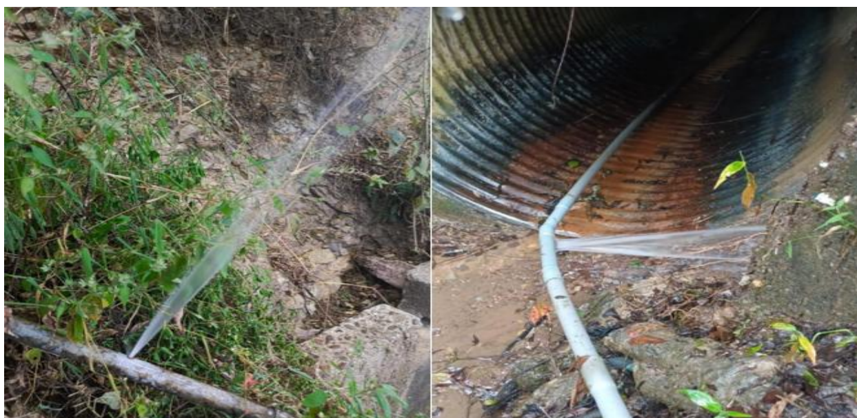
Figura 18. Fugas de agua en los puntos de implementación de accesorios artesanales.
