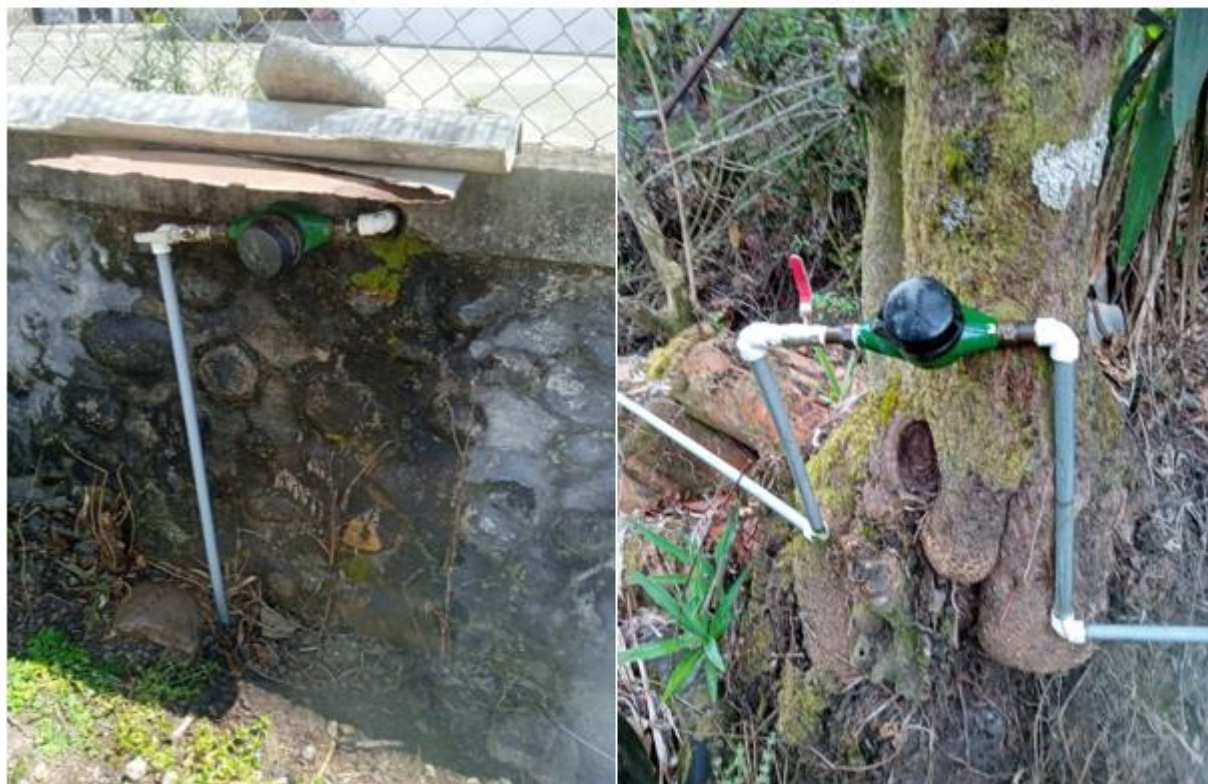
Figura 23. Estado de las acometidas domiciliarias.
