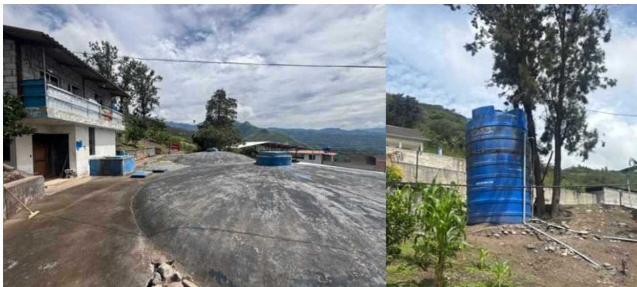
Figura 8. Tanque de distribución de la zona Los Pueres.
