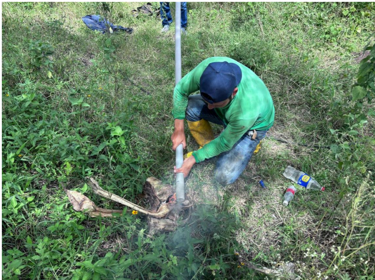
Figura 12. Mala práctica en la reparación de tuberías.
