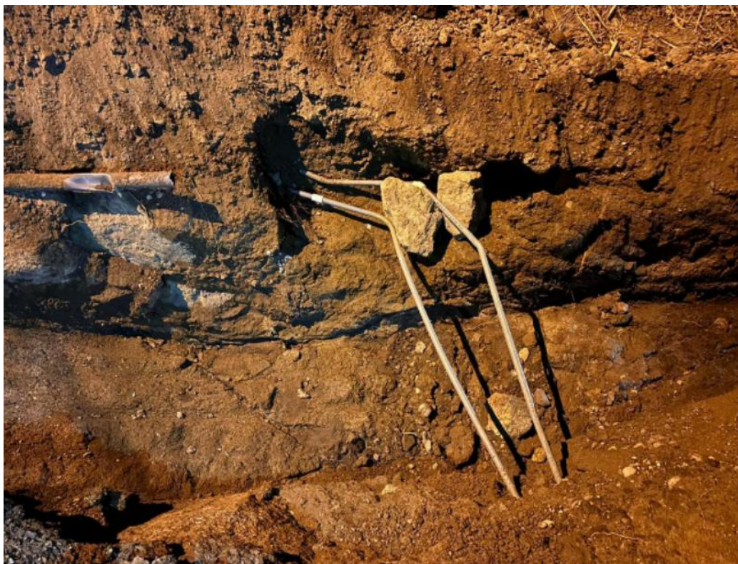
Figura 19. Fugas de agua por el uso de materiales diferentes.
