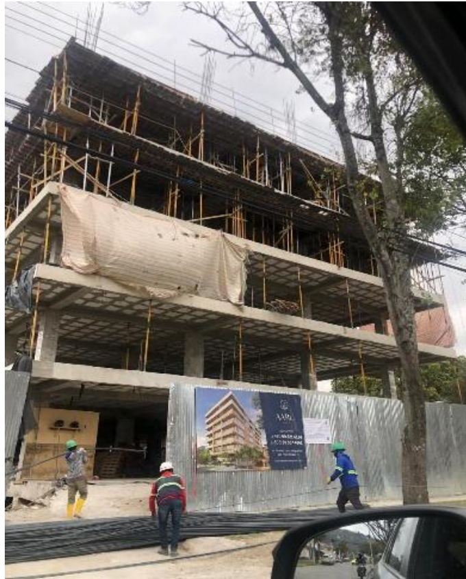
Figura 7. Estructura Pórticos especiales sismorresistentes de hormigón armado en la ciudad de Cuenca
