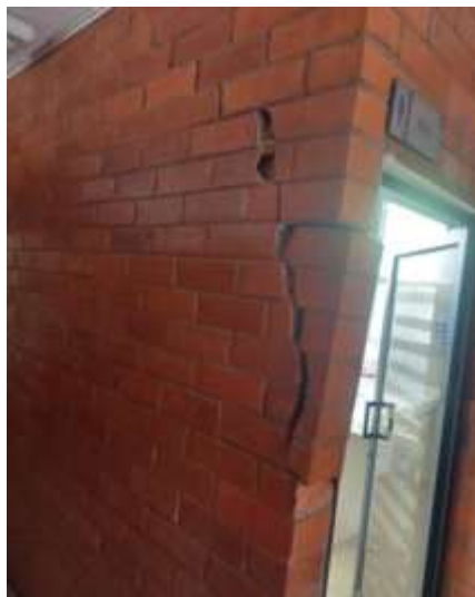
Figura 1-16: Afectación a la infraestructura del bloque C1
