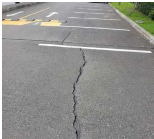
Figura 1-12: Evidencias de fisuras facultad CCTT.
