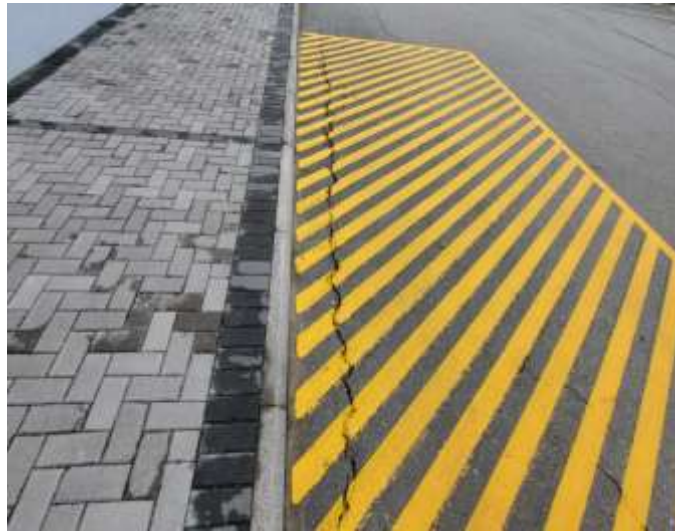
Figura 1-13: Evidencias de fisuras facultad CCTT.
