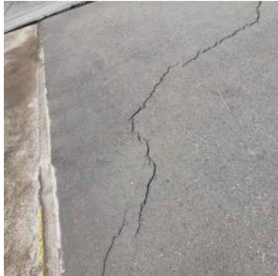
Figura 1-11: Evidencias de fisuras facultad CCTT.
