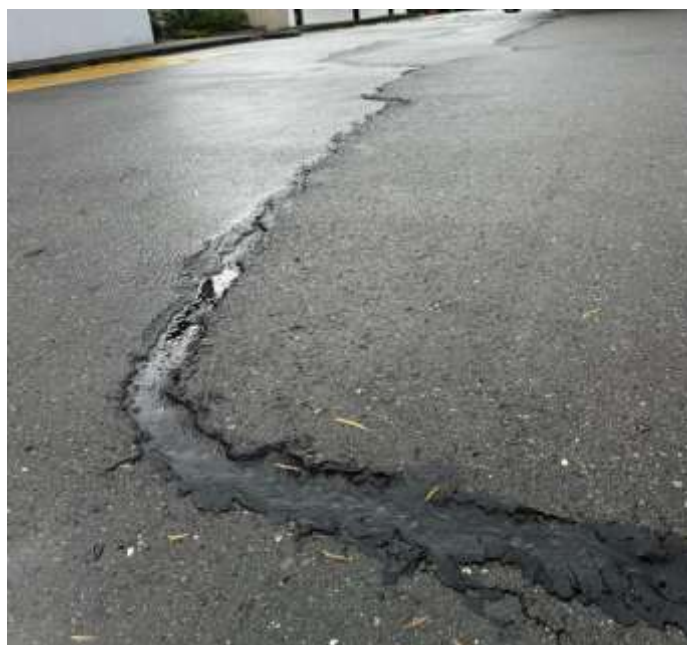
Figura 1-15: Evidencias de fisuras facultad CCTT.
