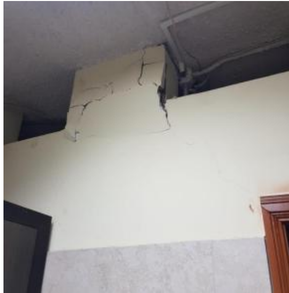
Figura 1-6: Daño en columna primera planta alta
