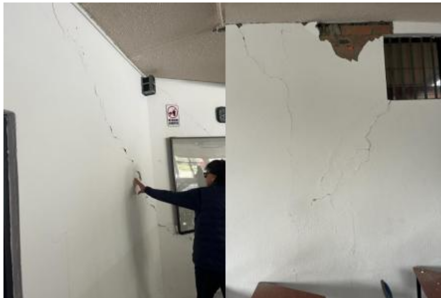
Figura 1-5: Daño en mampostería
