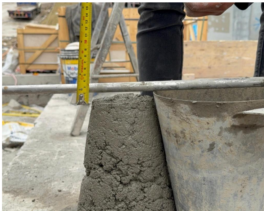
Figura 12-3: Asentamiento de Hormigón por método proyectado (shotcrete).
