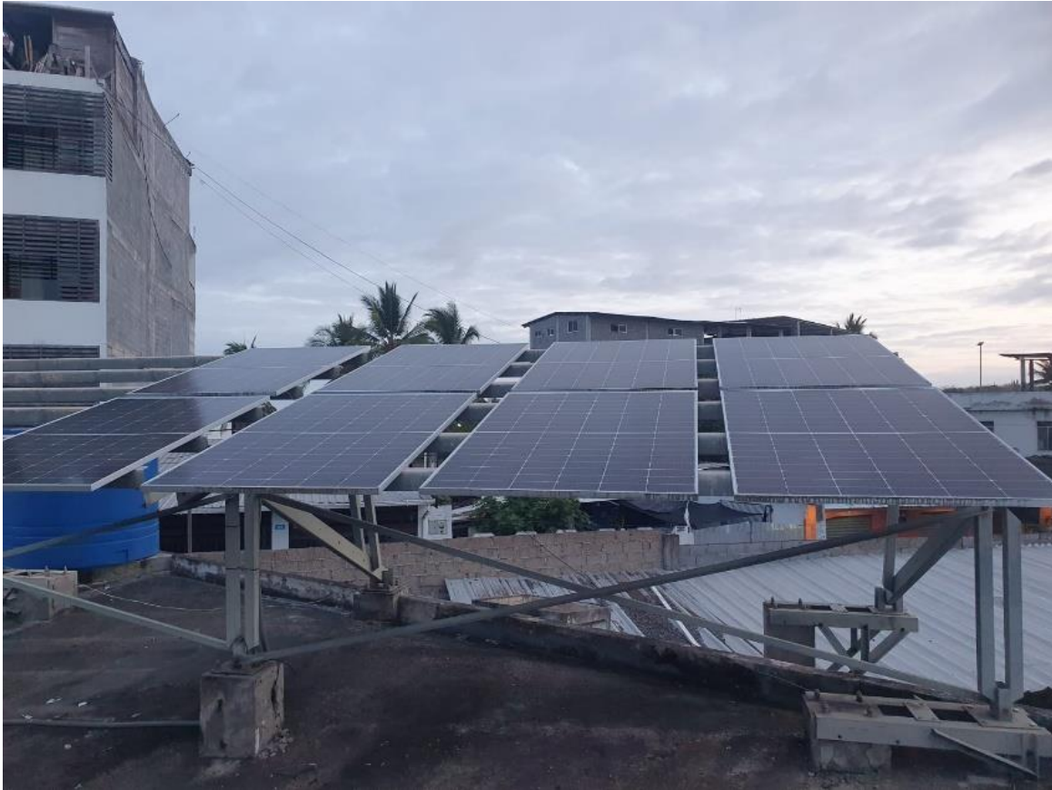
Figura 1. Paneles solares ubicados en la losa del baño de mujeres.
