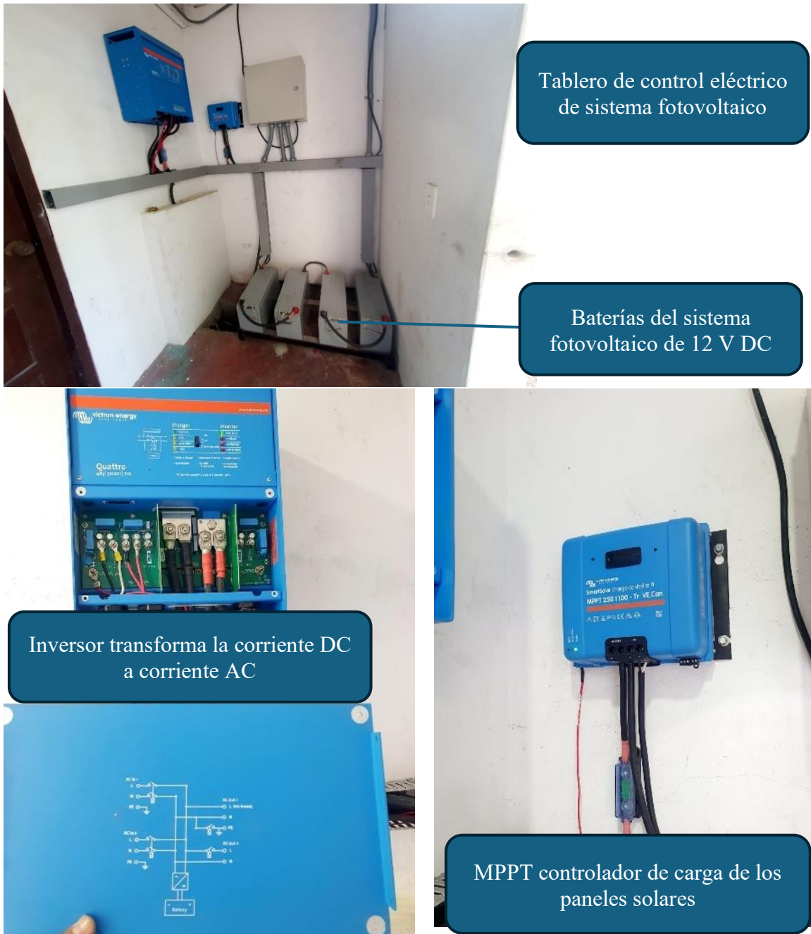
Figura 14. Componentes del sistema fotovoltaico instalado en el Colegio Nacional Galápagos, con un inversor de 120V, controlador de carga MPPT, tablero eléctrico y banco de baterías de 12 V
