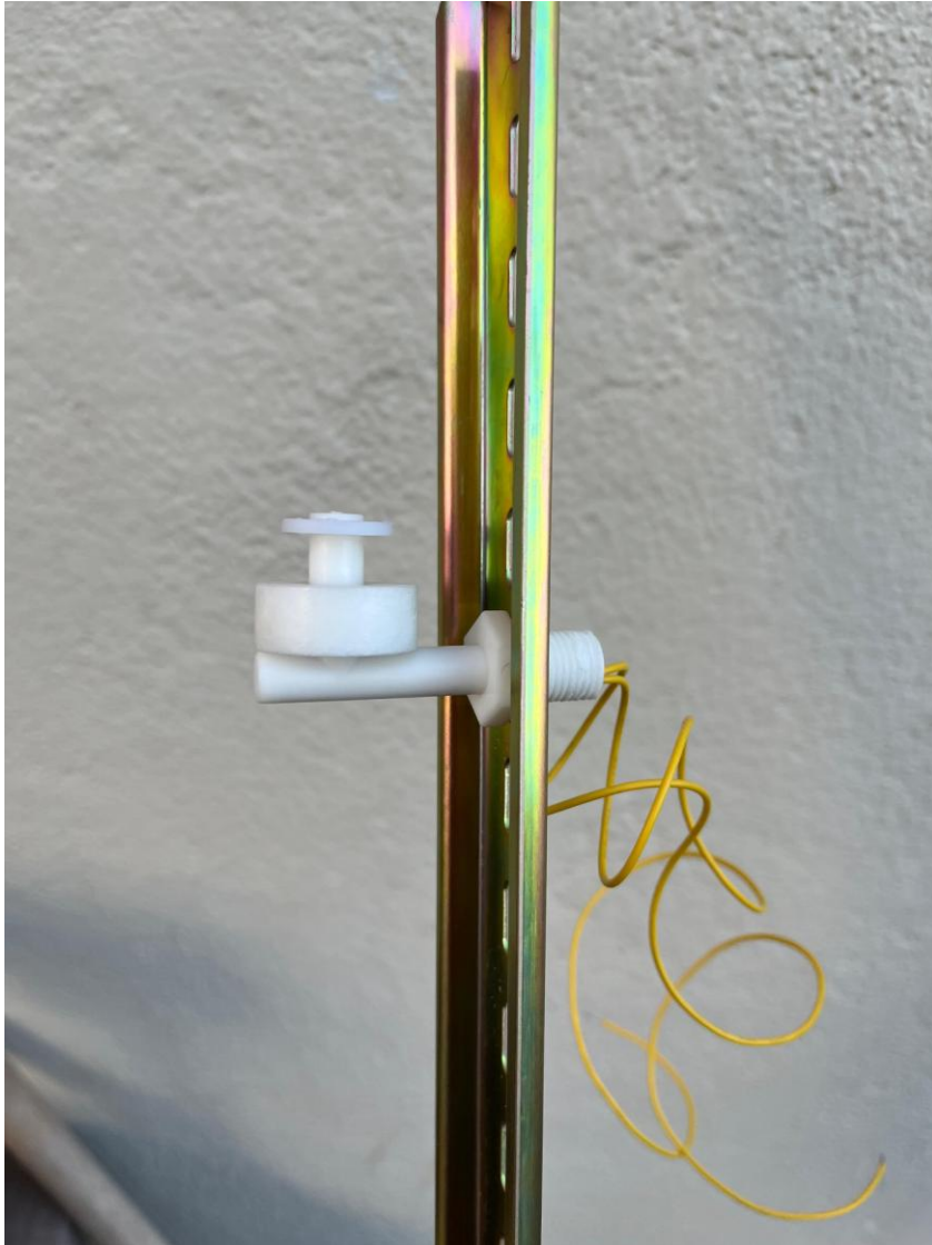
Figura 14 Colocación y revisión de los sensores
