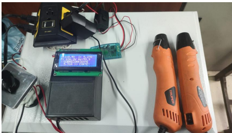
Figura 18 Detección de sobre corriente — pistolas de calor (5.27 A)
