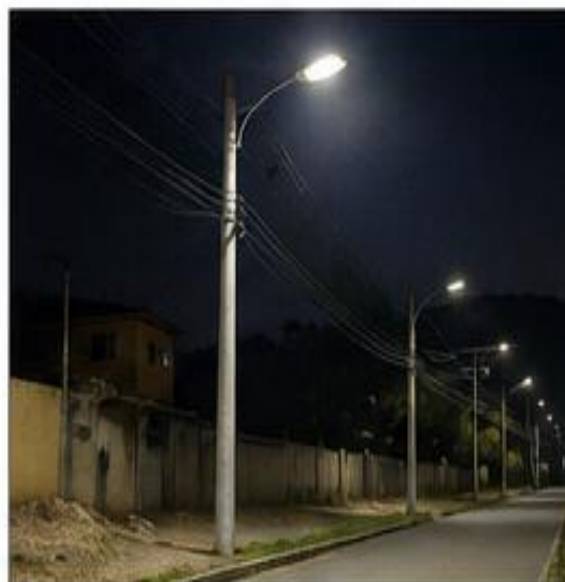
Iluminación LED en funcionamiento
