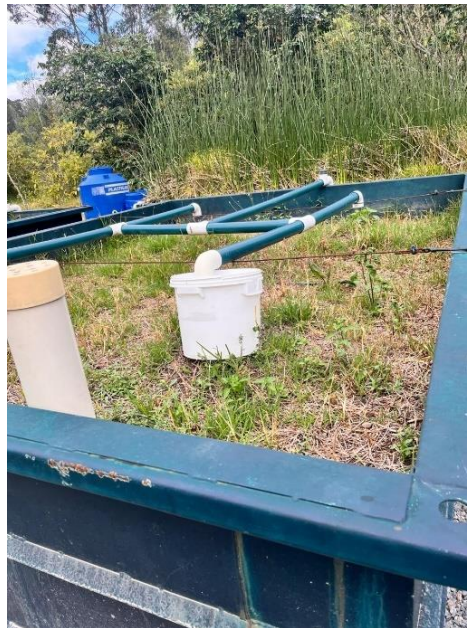
Figura 2. Humedal construido piloto durante la operación inicial.
