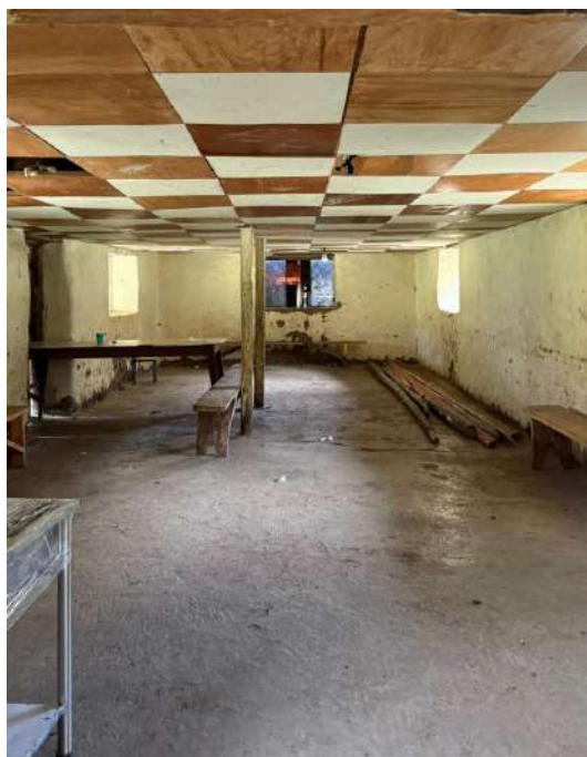
Figura 18. Registro fotográfico - estado actual escuela vieja. Nota. Elaboración propia, 2025.
