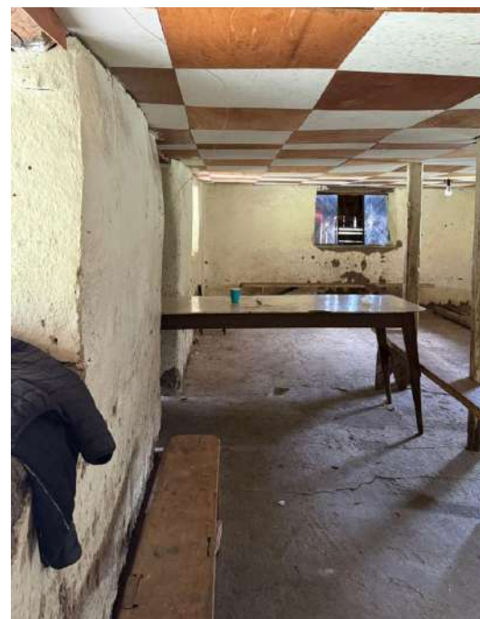
Figura 19. Registro fotográfico - estado actual escuela vieja. Nota. Elaboración propia, 2025.
