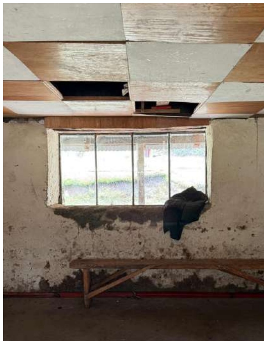
Figura 16. Registro fotográfico - estado actual escuela vieja. Nota. Elaboración propia, 2025.
