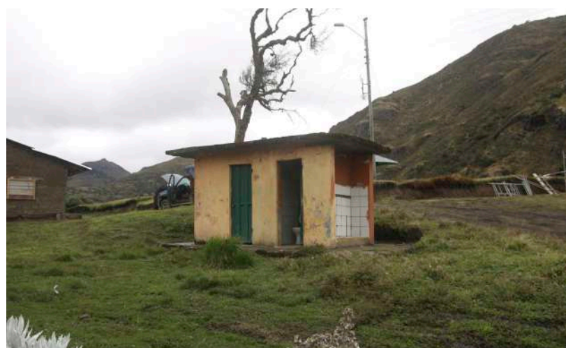
Figura 21. Registro fotográfico - estado actual baños. Nota. Elaboración propia, 2025.
