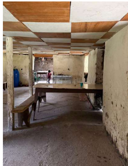
Figura 17. Registro fotográfico - estado actual escuela vieja. Nota. Elaboración propia, 2025.
