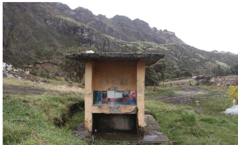
Figura 20. Registro fotográfico - estado actual baños. Nota. Elaboración propia, 2025.
