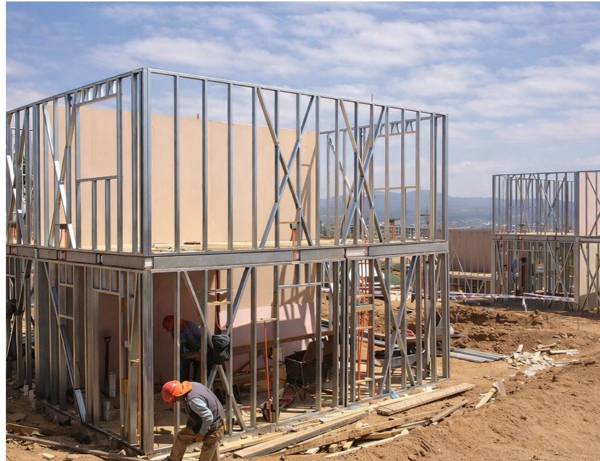
Figura No. 58. Proceso de construcción en seco con Steel Frame. Nota. Adaptado de Estructura de perfiles de acero para construcción en seco [Fotografía], por Redacción Área Tres, 2022, Revista Área Tres ( https://www.revistaareatres.com ).
