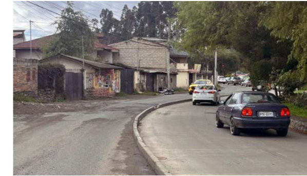
Figura 4: Deterioro del pavimento. Nota: Autoría Propia
