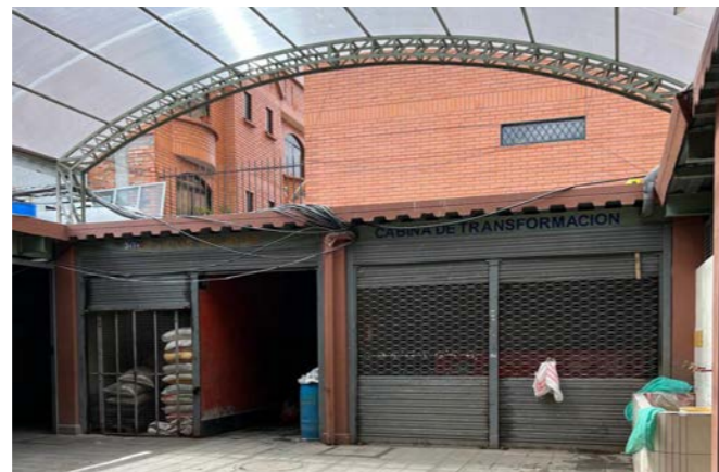
Figura 108: Área de servicio Fuente: Elaboración propia
