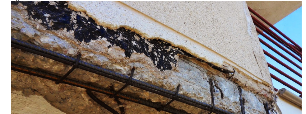
Fig.29. Corrosión en la estructura
