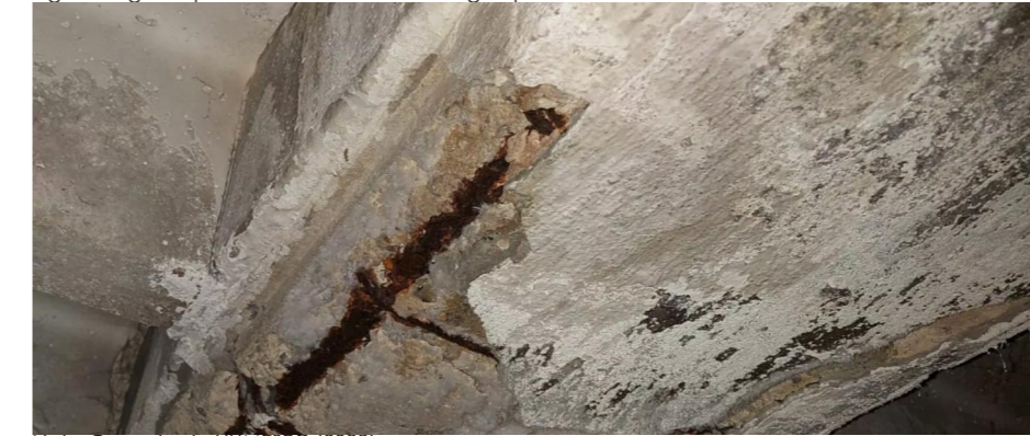
Fig. 26. Viga Empotrada en muro de hormigón presenta carbonatación
