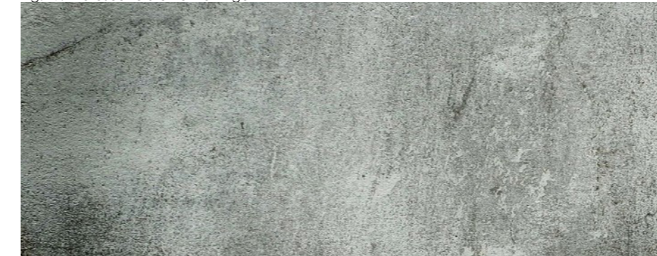
Fig. 27. Eflorescencia en el hormigón
