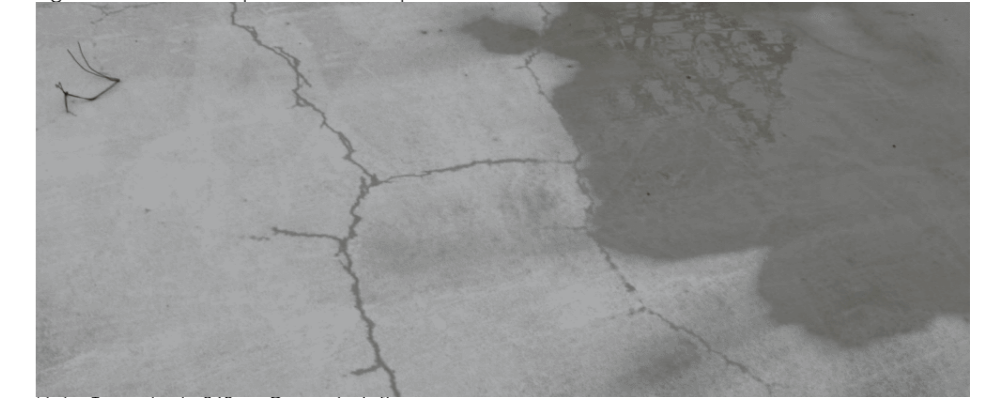
Fig.28. Losa con fisura por contracción plástica
