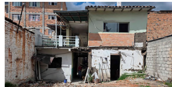
Figura 52 Fotografía desde el patio, construcción en mal estado Nota. Arq. Álvaro Maldonado.
