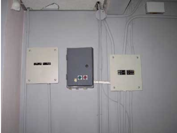
Ref. 8-09 Tablero de Acometida Eléctrica
