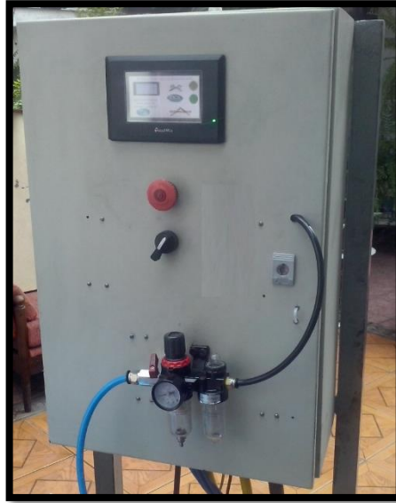
Figura 5. 6. Centro de control de la máquina automatizada.
