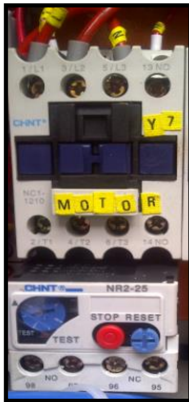
Figura 4. 12. Contactor y térmico comando para motoreductor CHINT.
