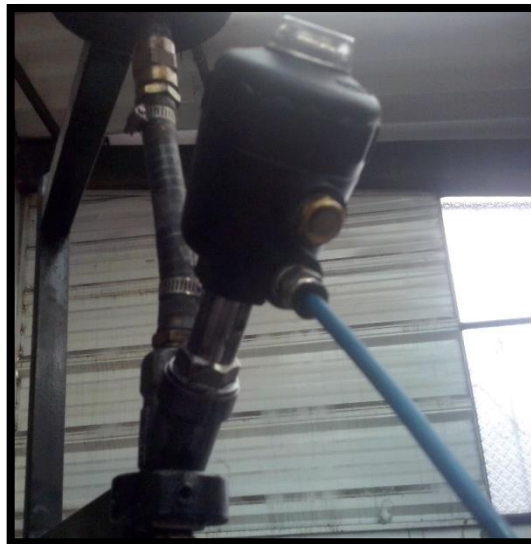
Figura 5. 19. Conexión neumática para válvula abastecimiento de pintura.
