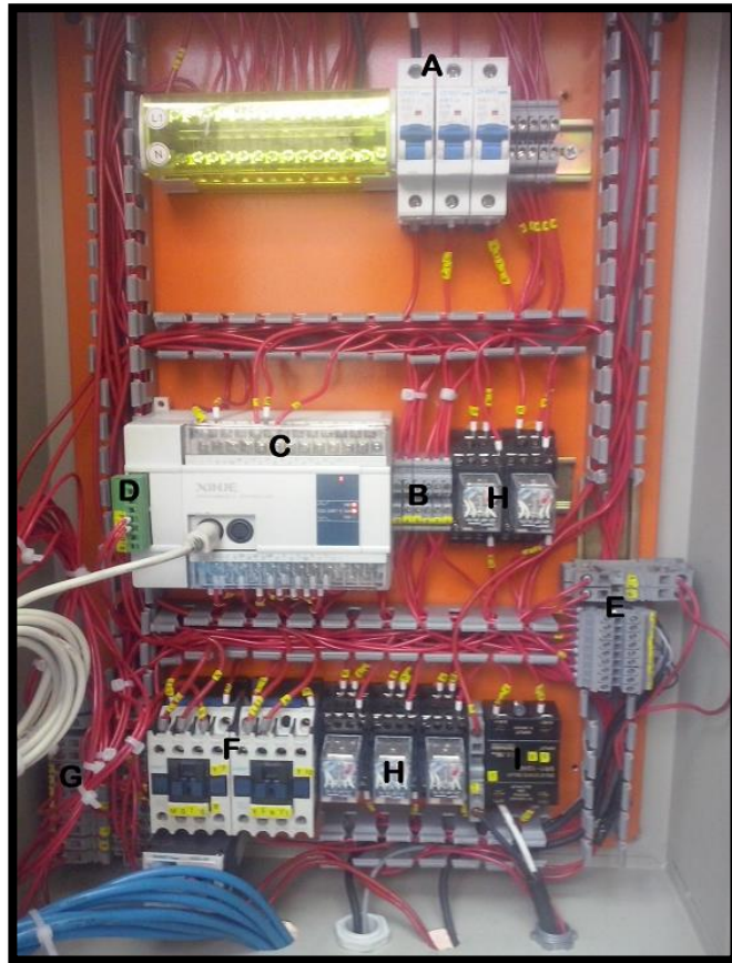
Figura 5. 8. Partes del centro de control.
