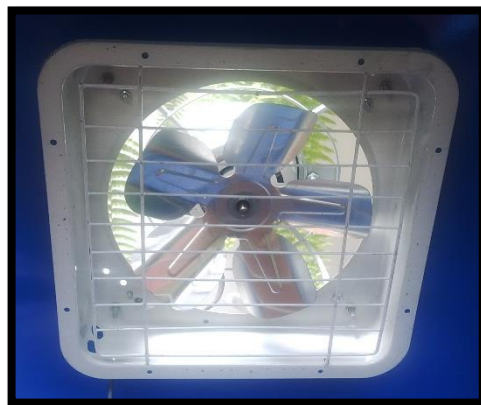
Figura 3. 59. Ventilador eléctrico acoplado en el sistema de secado.
