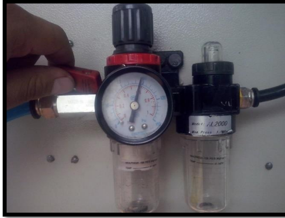
Figura 5. 34. Llegada de aire al sistema de control.
