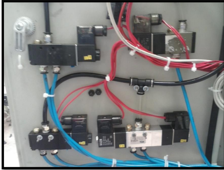
Figura 5. 14. Conexión neumática de electroválvulas.
