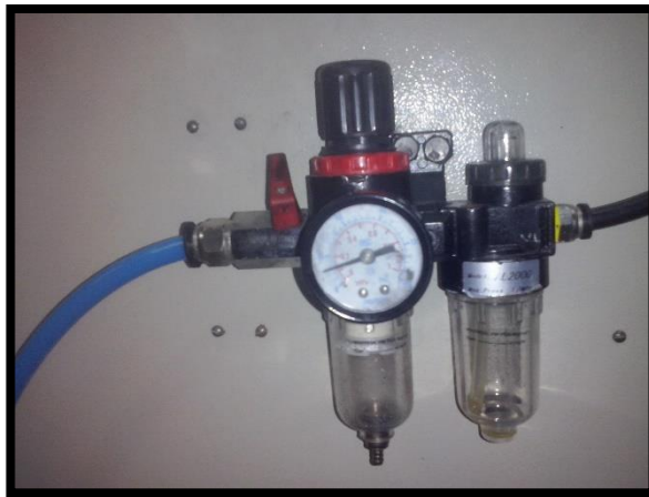
Figura 5. 13. Unidad de mantenimiento 1/4 "
