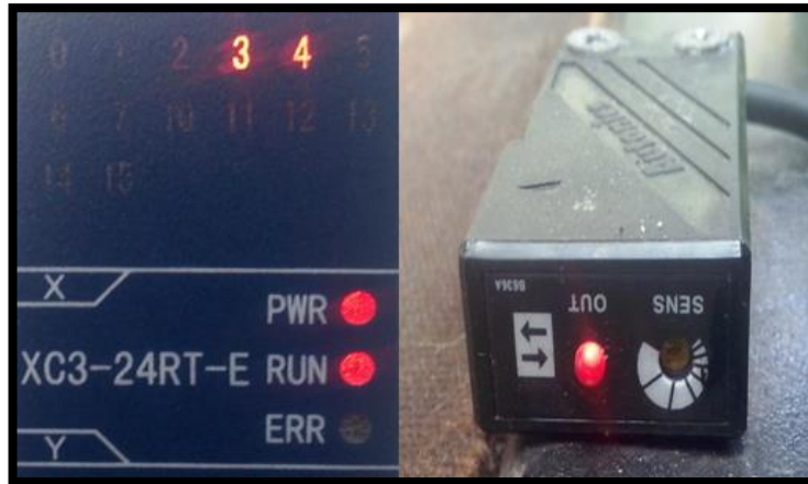
Figura 5. 21. Señal de sensor fotoeléctrico.
