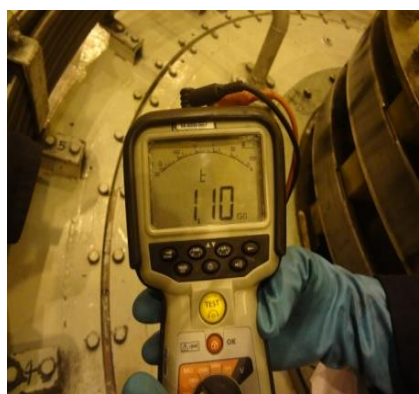
Ilustración 29. Mega óhmetro utilizado para verificar la limpieza y humedad. (Fuente propia)
