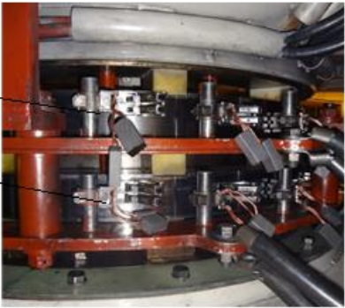
Ilustración 8. Disposición de escobillas en los anillos colectores.
