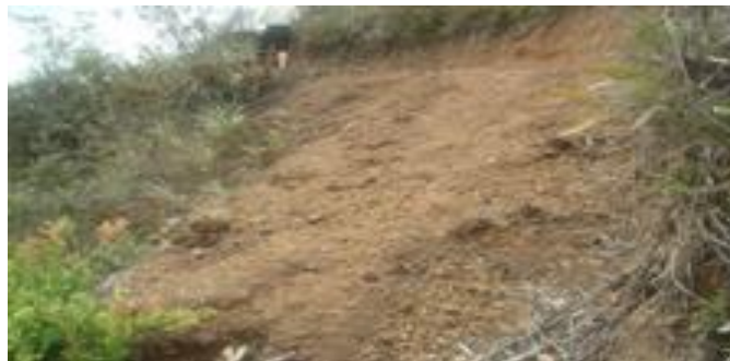
Fotografía 10: Erosión en el Sendero “La Cascada”.
