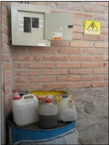
Fig. 3.5 Acopio de aceites usados en zona inadecuada
