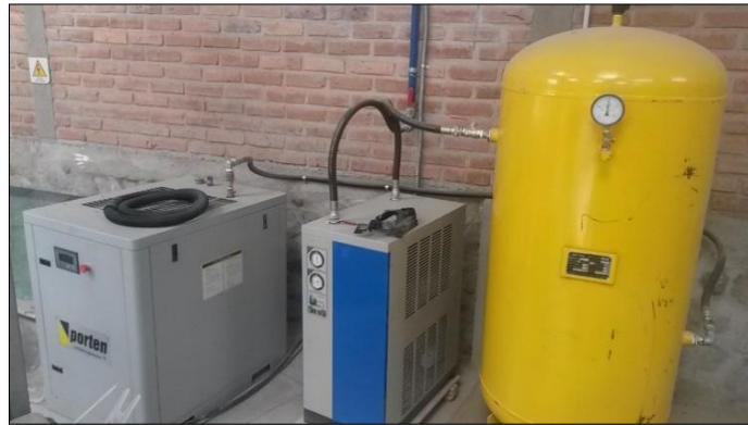
Fig. 3.20 Compresor volumétrico Porten, enfriador, tanquede almacenamiento.
