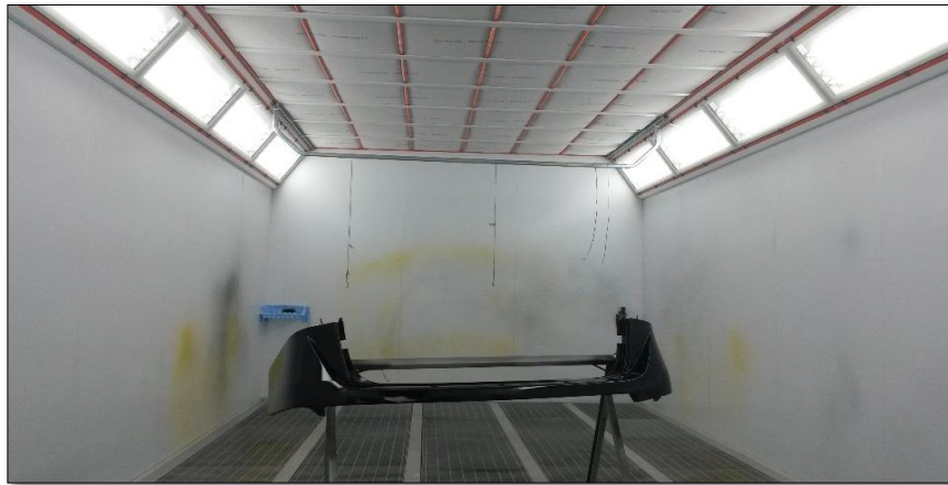
Fig. 3.29 Cabina de pintura KONGER
