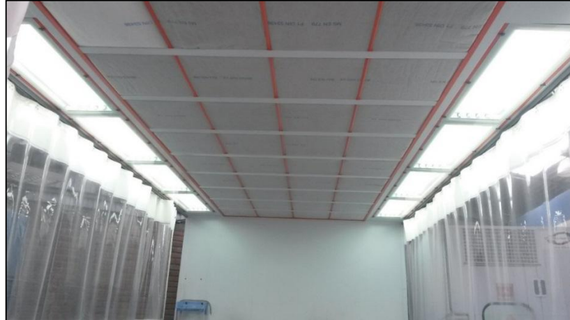
Fig. 3.13 Iluminación en la cabina express.
