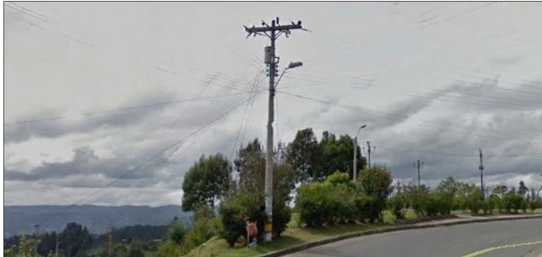
Figura 3.140 Nuevo poste para el Reconector 29.
