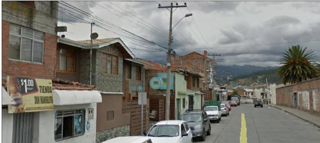
Figura 3.161 Nuevo poste para el Reconector 17.
