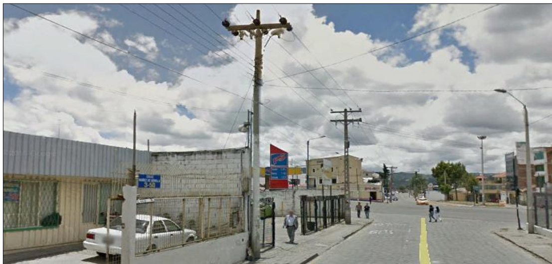
Figura 3.136 Nuevo poste para la antena del Reconfigurador 13, 23 y 25.
