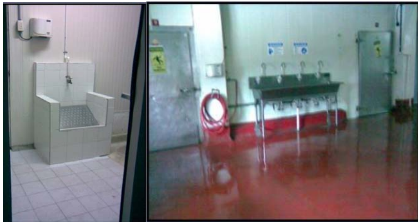
Fotografía 5 - 4: Instalaciones de sanitización.
