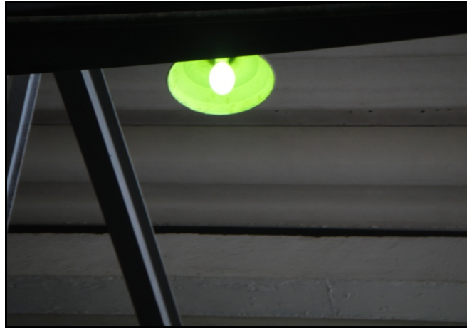
Fotografía 3 - 20: Iluminación sin protección.
