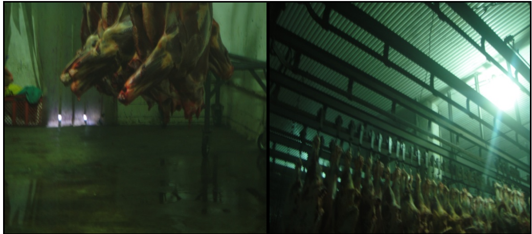
Fotografía 3 - 26: Área de refrigeración
