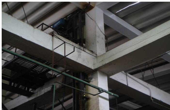
Fotografía 3 - 19: Instalaciones eléctricas y de agua.
