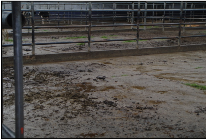
Fotografía 3 - 7: Falta de drenaje en el piso.
