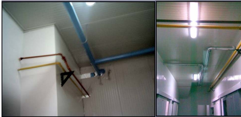
Fotografía 5 - 1: Tubería identificada por colores.
