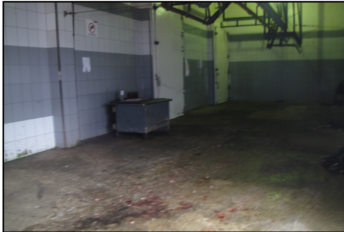
Fotografía 3 - 12: Estado actual de los pisos del área de despacho.
