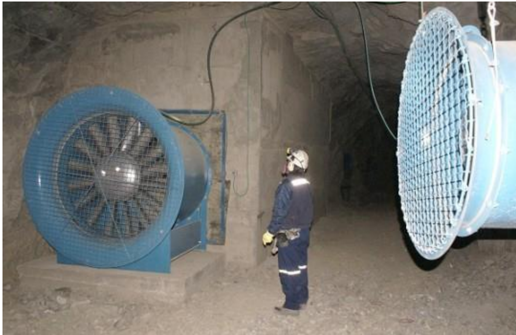
Figura 1.5. Ventilador axial en mina subterránea Fuente: (Minería Chilena, 2014)
