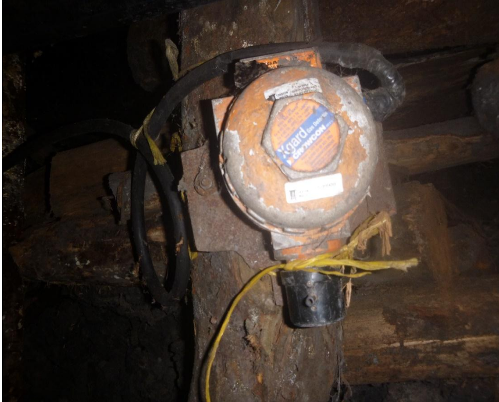
Anexo 3. Punto de monitoreo de CH4 en el nivel 15. Fuente: Ing. Alan Daza.
