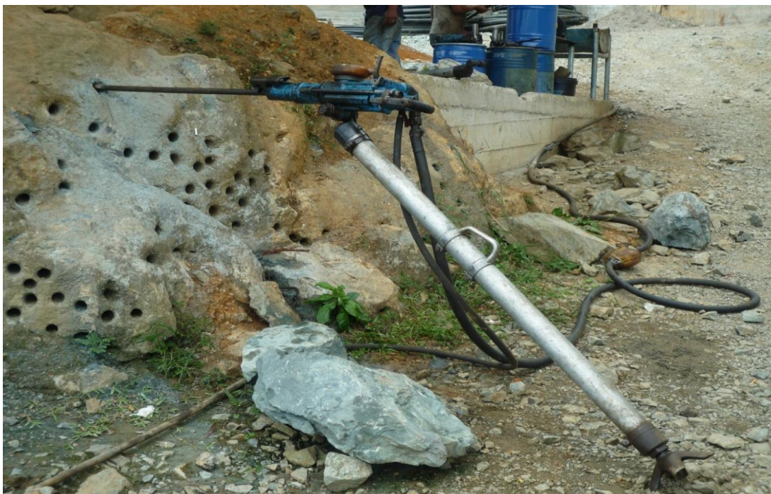
Figura # 17 Perforadora YT27
