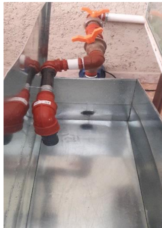
Figura 3.1 Depósito de almacenamiento de agua
