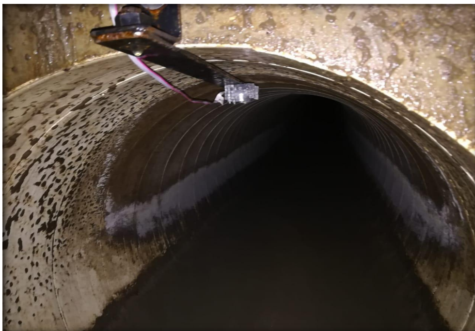
Figura 3.33: Tubería del Interceptor XII-A
