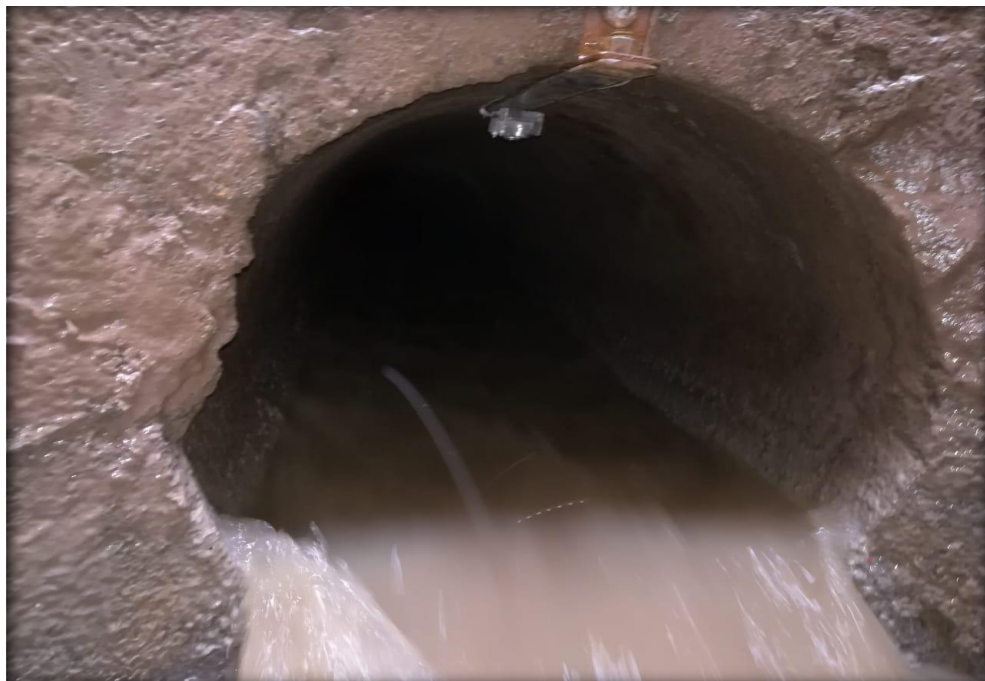
Figura 3.28: Tubería del Interceptor X
