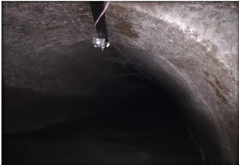
Figura 3.42: Tubería del Interceptor XVIII
