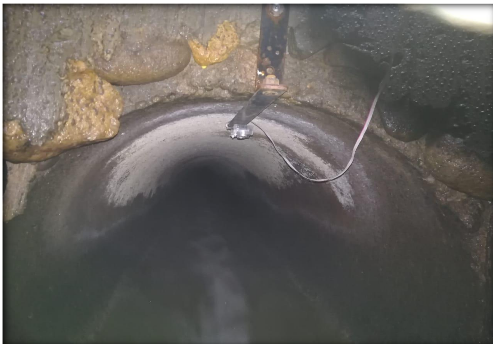
Figura 3.24: Tubería del Interceptor IX
