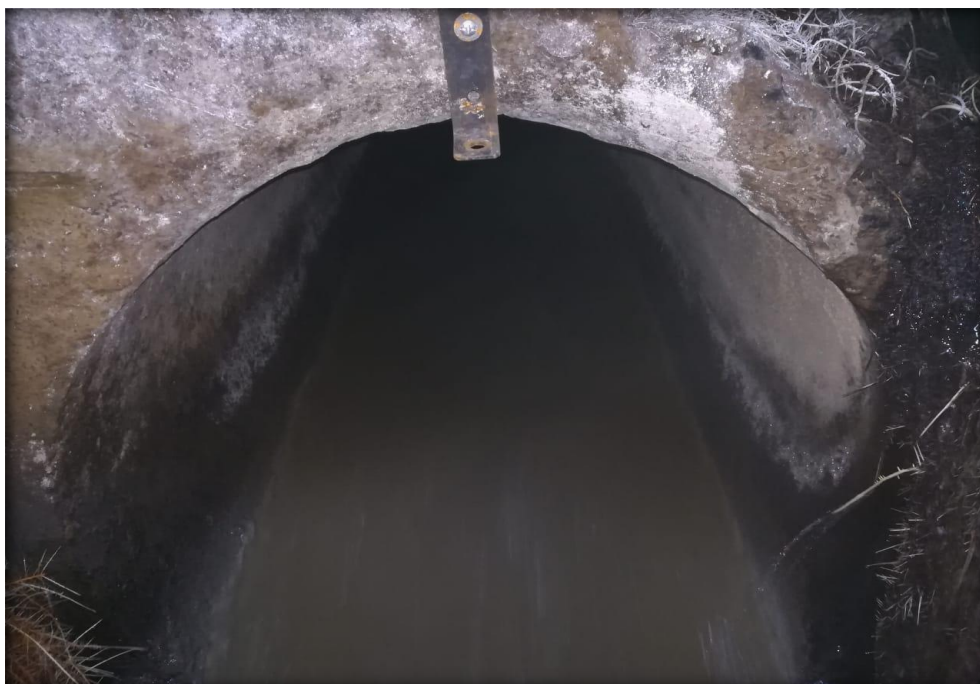
Figura 3.15: Tubería del Interceptor III
