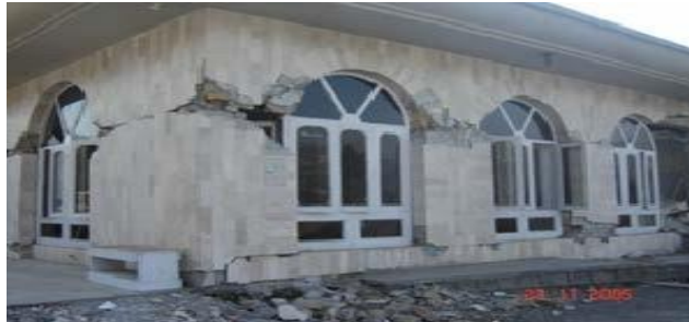
Figura 4.3 Falla por balanceo y desprendimiento de ladrillos de un edificio de mampostería no reforzado. Fuente: NZ1-C8, 2016.
