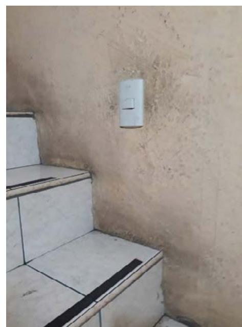
Ilustración 83. Interruptor mal colocado
